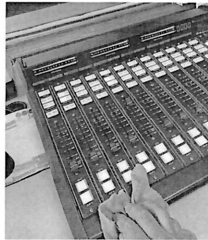
Limpieza de consola de transmisión
