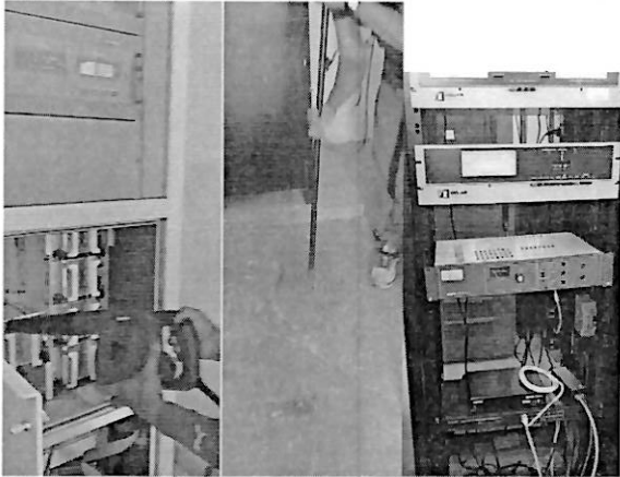
Limpieza a transmisor equipo receptor de señal, enlace estudio-planta, y en general a la caseta de transmisión.
