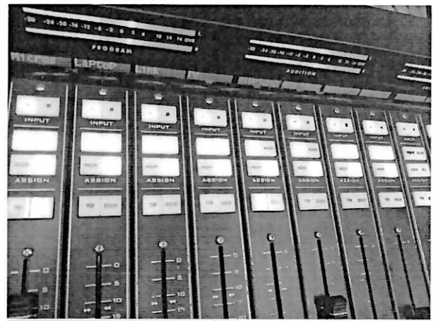
Limpieza de consola de transmisión
